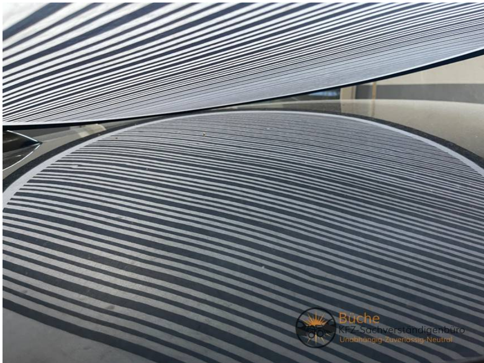
Hagelschaden auf Dach
