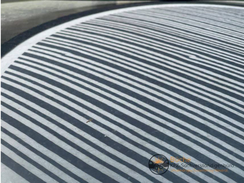
Hagelschaden auf Dach
