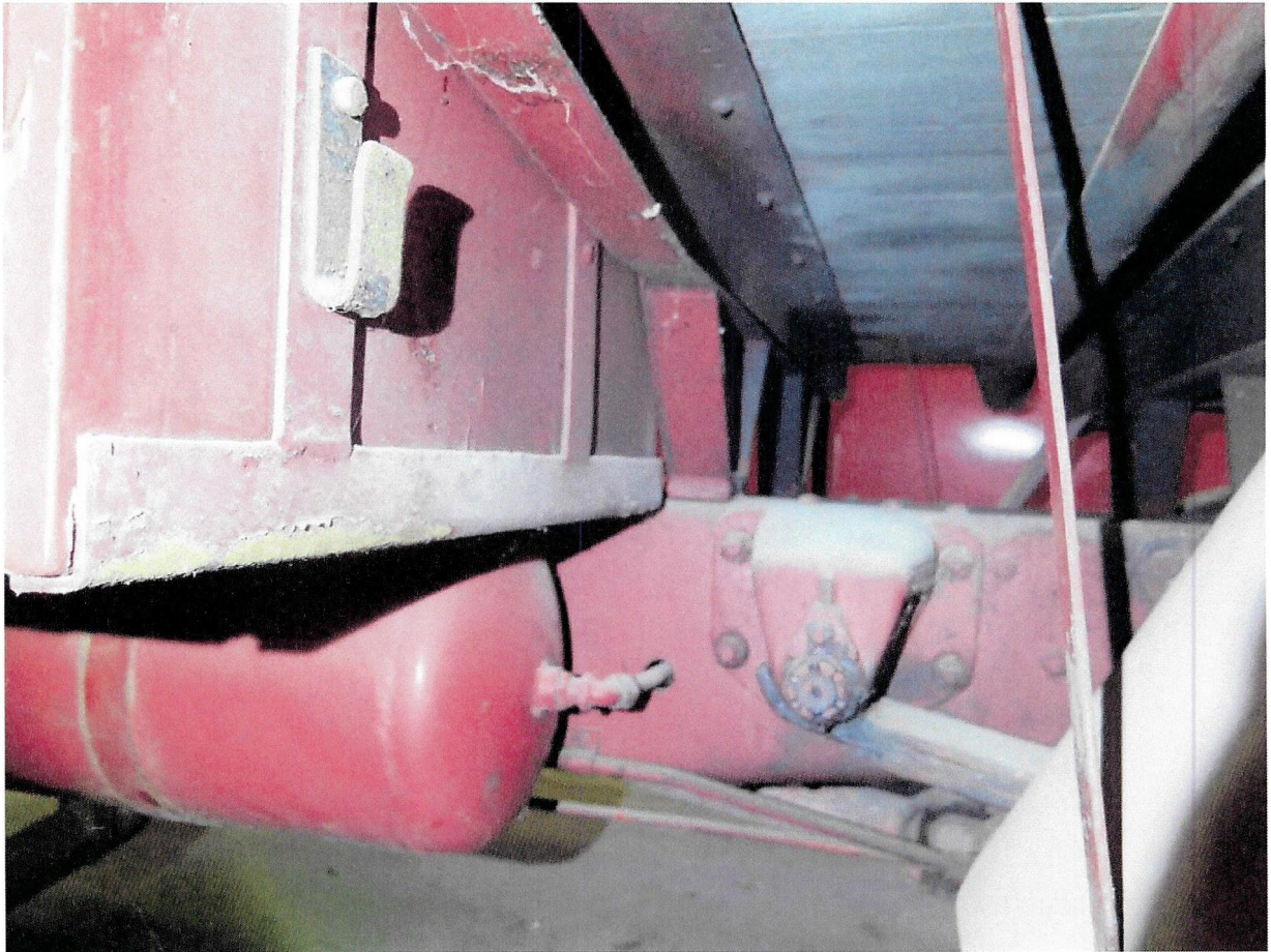
Bildbeschreibung: Detailaufnahme - LKW 01 Unterboden links hinteres Drittel
