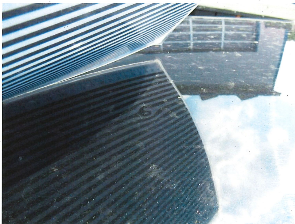
Bild 17: Punktuelle Eindellung des Daches
